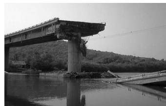
Mexiko, 2003: Brückeneinsturz infolge Wasserstoffversprödung
